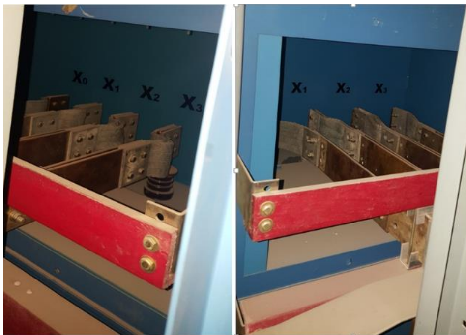
Figura 11. Vista de acoplamiento de barras a boquilla de transformadores, izquierda 34.5kv y derecha 13.8kv
