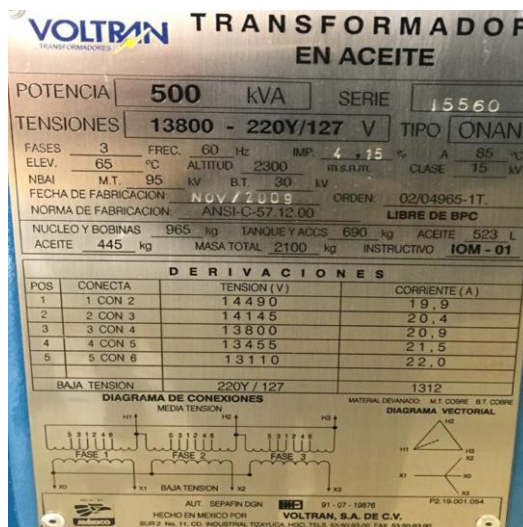
Figura 5. Placa Trasformador secundario 13.8Volts
