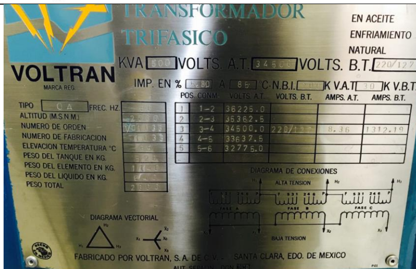
Figura 4. Placa Trasformador principal 34.5kV
