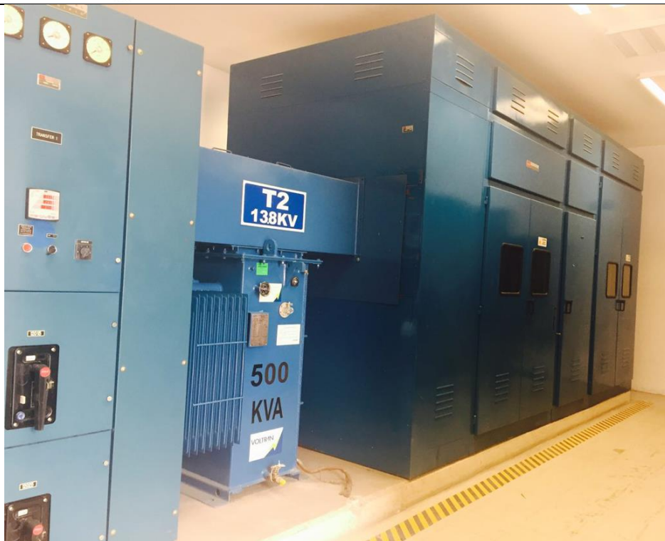
Figura 8. Vista de Acometida 13.8KV, Interior de subestacion
