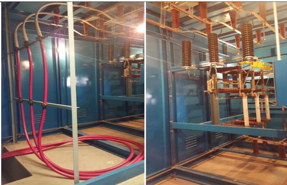
Figura 10. Vista interior de acometida de 34.5KV
