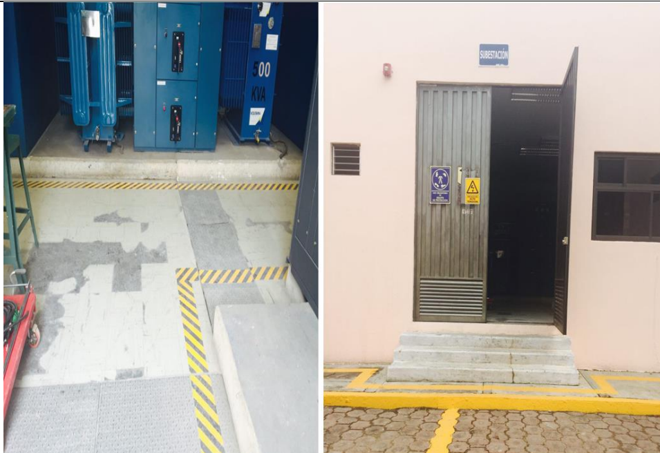
Figura 12. Condiciones de acceso a Subestación y Transfer actual
