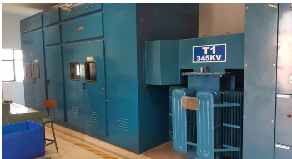
Figura 9. Vista de Acometida 34.5KV, Interior de subestacion
