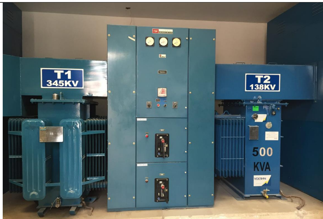
Figura 2. Tablero de Trasferencia y Transformadores
